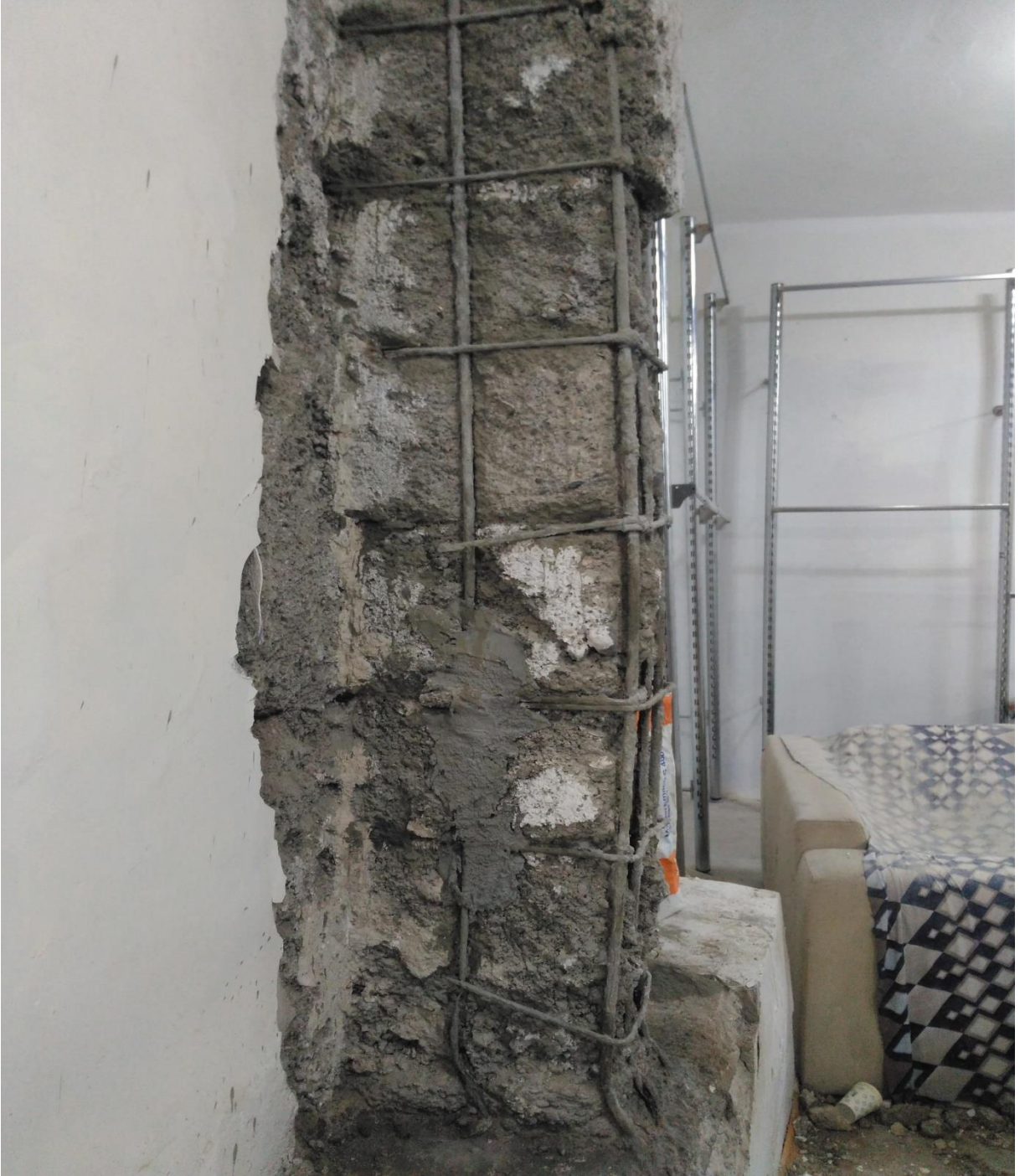
Koroyon ve donatısı flambaja uğramış mevcut kolon.
