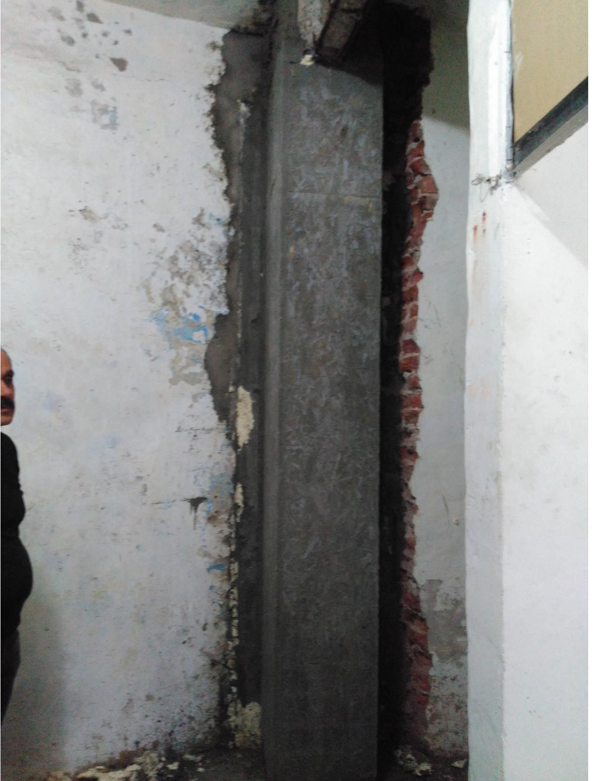
Graut betonu dökülmüş kolon.
