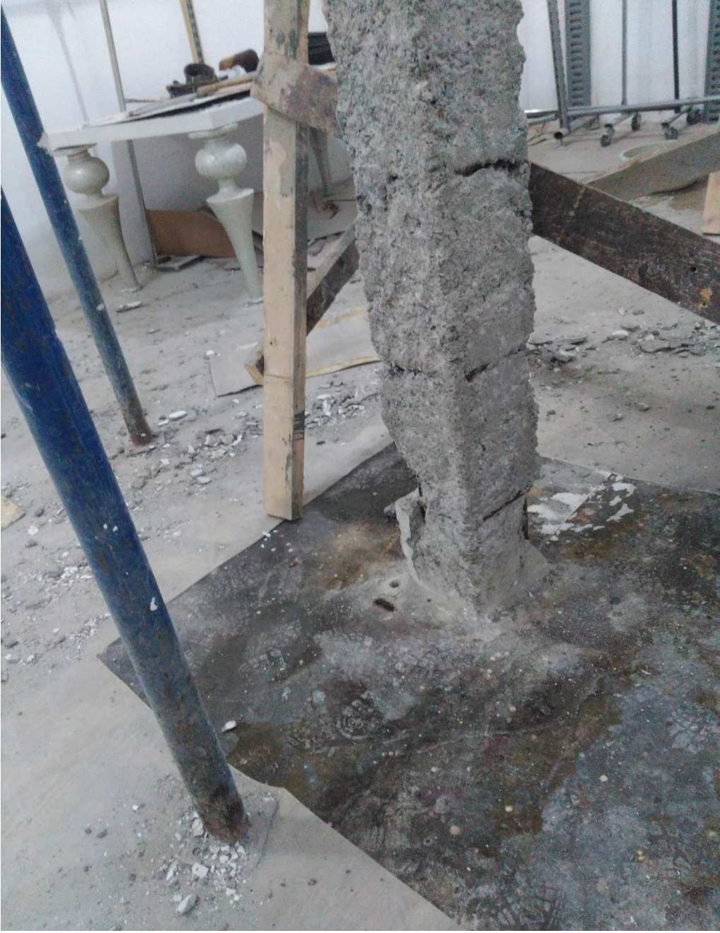
Mevcut hasarlı kolon.
